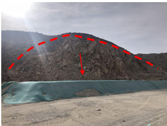
照片 4-9 X6 不稳定斜坡（潜在崩塌）
