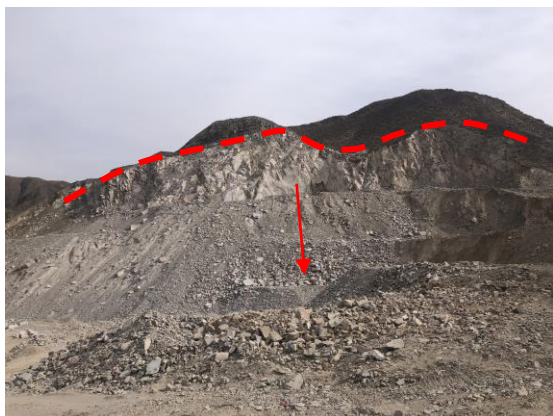
照片 4-3 X1 不稳定斜坡（潜在崩塌）
