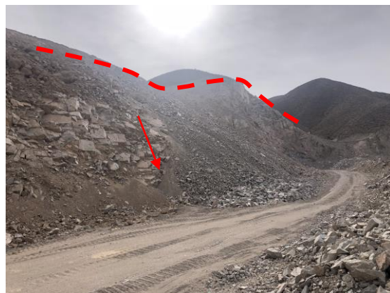
照片 4-4 X2 不稳定斜坡（潜在崩塌）
