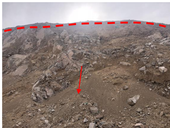
照片 4-6 X3 不稳定斜坡（潜在崩塌）
