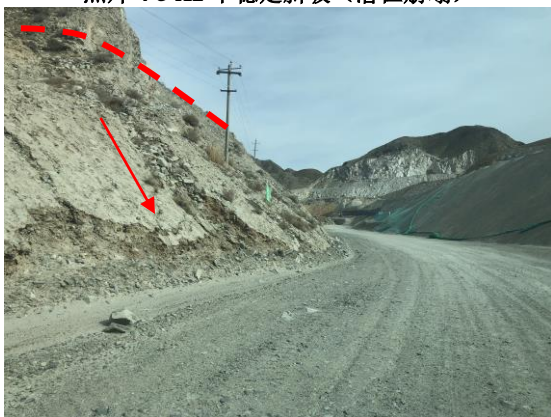
照片 4-7 X4 不稳定斜坡（潜在崩塌）
